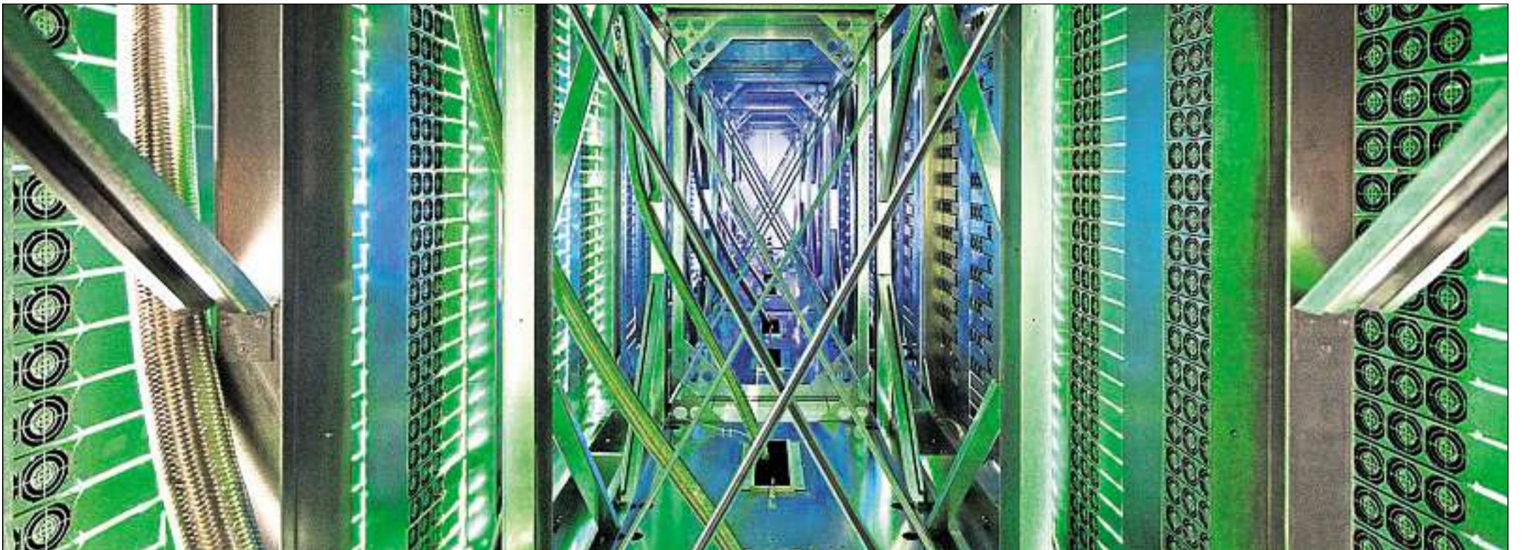
Rechenzentren wie dieses von Google sind riesige Anlagen. Tausende Ventilatoren leiten die heiße Luft in eine Kühlinheit. Das grüne Licht stammt von den Status-Lämpchen der Server.
